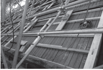
図12 新たに木枠が挿入された屋根面 木枠の間に断熱材を入れて構造用合板を設置。
